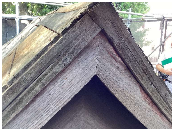
は ぶ 破風板にベンガラの塗装が確認された
