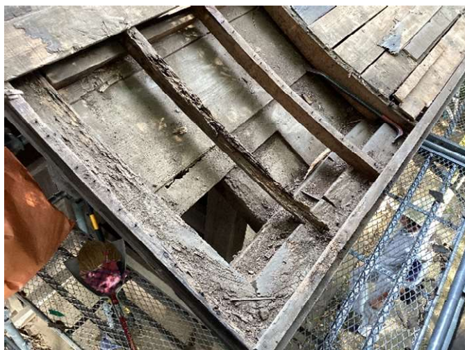
南東角の軒先の状況 の だ る き 野垂木などが傷んでいる
