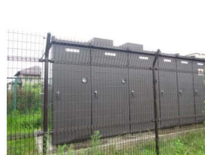
・既存電気設備
