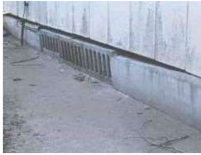
写真②：構造材(基礎)の破損
