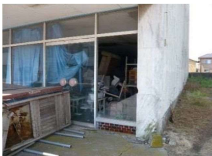
写真②：窓ガラスの破損
