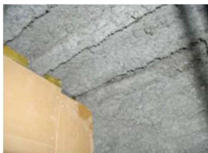
写真②：吹付け石綿
