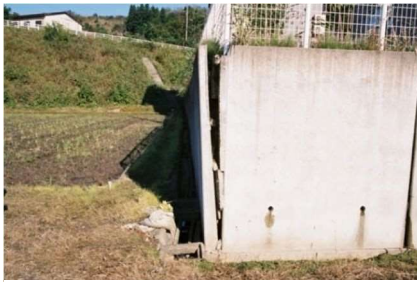
写真④：擁壁の傾き
