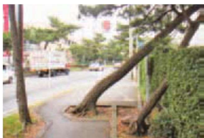
写真④：不自然な傾斜
