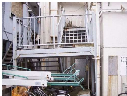
写真③：屋外階段の傾斜
