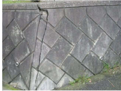
写真②：コーナー部分のひび割れ
