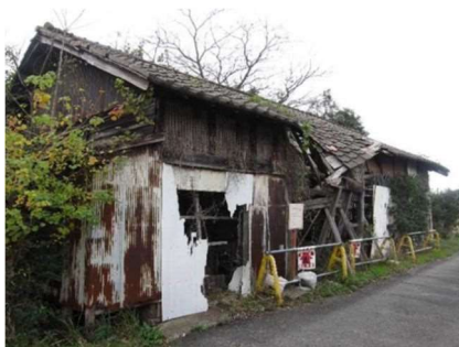
写真②：外装材の劣化・破損
