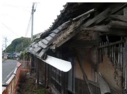
写真①：軒の破損
