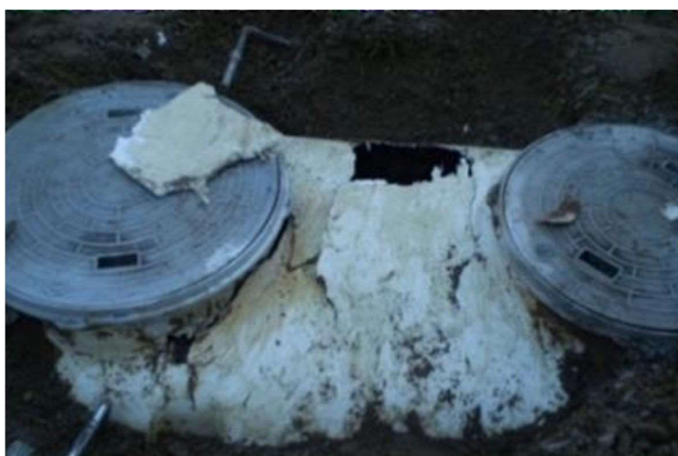
写真①：浄化槽上部の破損
