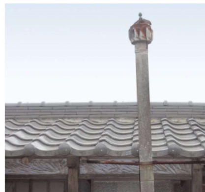
写真⑥：石綿使用部例 煙突材
