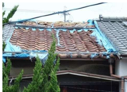
写真③：屋根ふき材の脱落
