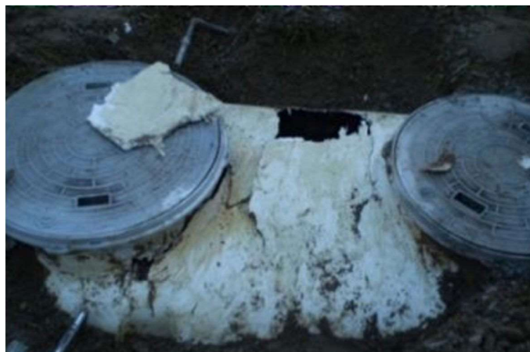
写真①：浄化槽上部の破損
