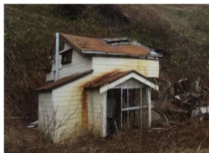
写真③：開口部の未施錠
