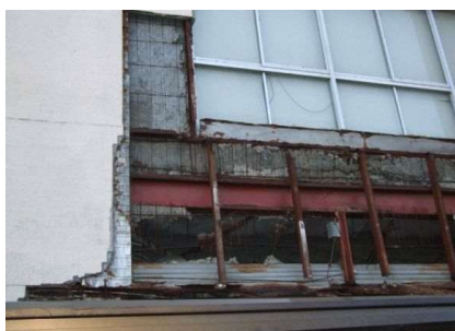
写真②：外壁の脱落
