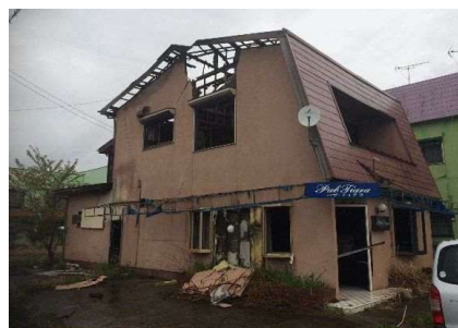
写真④：屋根の著しい破損
