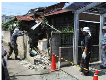
写真①：塀の破損
