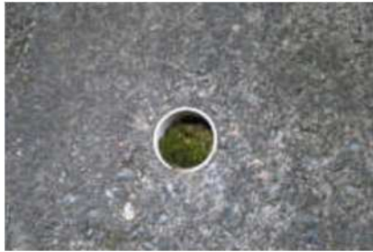
写真⑤：水抜き穴の詰まり
