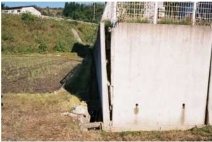
写真④：擁壁の傾き
