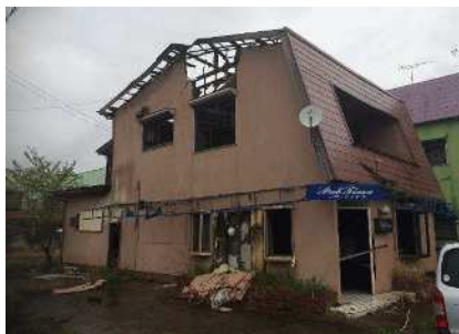
写真④：屋根の著しい破損
