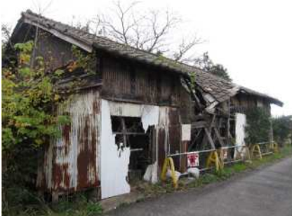
写真⑩：屋根の変形
