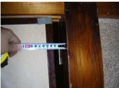
写真⑦：柱の傾斜
