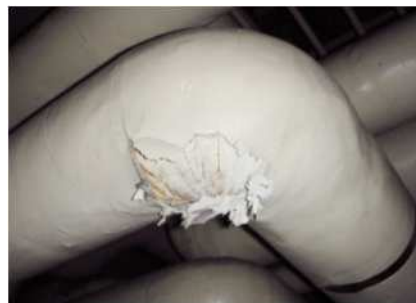
写真③：石綿使用部材（保温材）の破損
