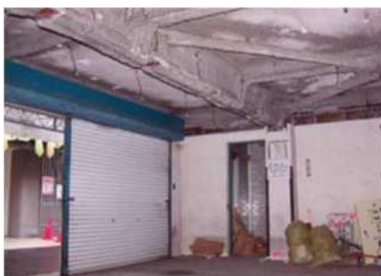
写真①：吹付け石綿の露出
