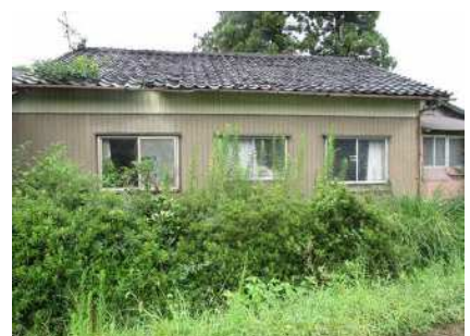
写真⑨：屋根のゆがみ
