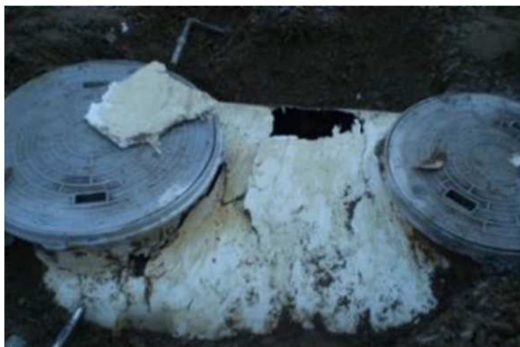
写真①：浄化槽上部の破損
