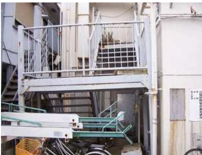
写真④：屋外階段の傾斜
