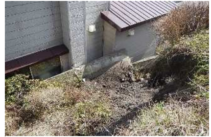
写真⑥：崩壊したコンクリート擁壁
