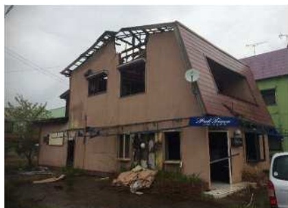
写真①：開口部等の破損
