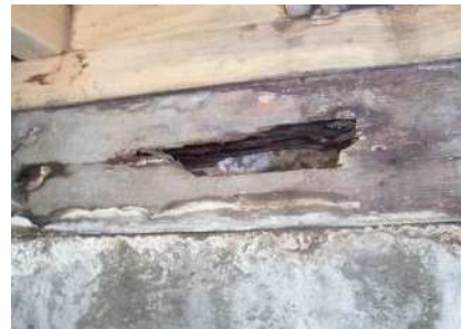
写真⑤：シロアリによる土台の損傷
