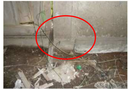
写真⑥：基礎、土台がずれている
