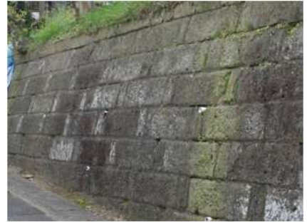
写真③：擁壁のふくらみ
