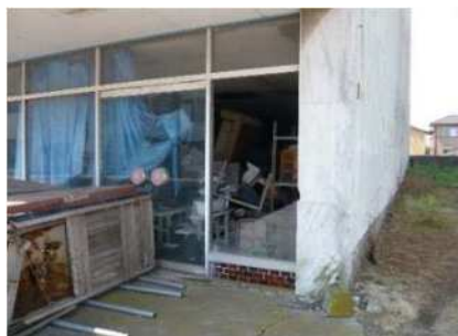
写真②：窓ガラスの破損
