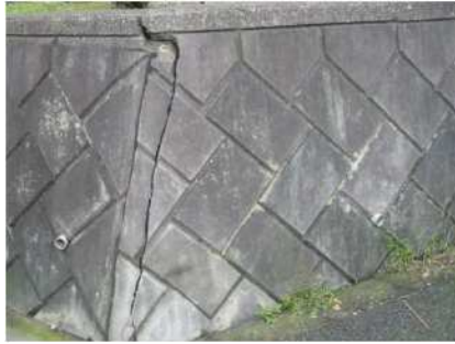
写真②：コーナー部分のひび割れ
