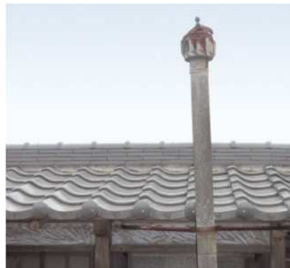
写真⑥：石綿使用部例 煙突材
