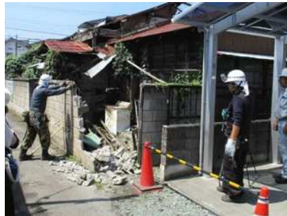
写真②：塀の破損
