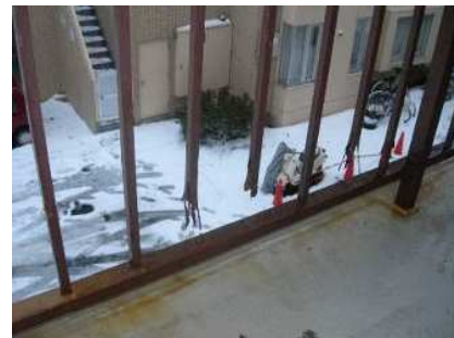
写真③：バルコニーの手すりの腐食
