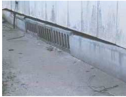
写真②：構造材(基礎)の破損
