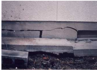
写真④：基礎の大きな欠損
