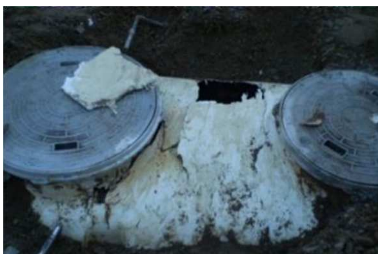
写真①：浄化槽上部の破損
