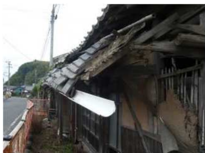
写真①：軒の破損
