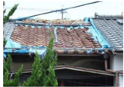
写真③：屋根ふき材の脱落
