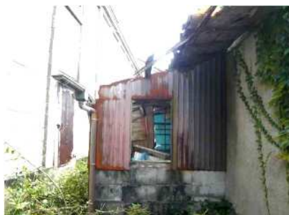
写真④：開口部等の破損
