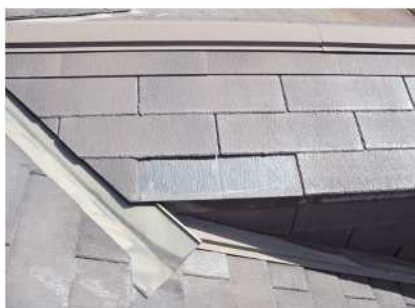
写真⑤：石綿使用の例 スレート屋根
