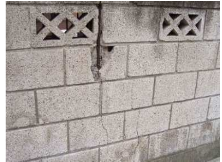
写真③：塀の大きなひび割れ
