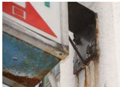
写真⑤：看板支持部分の著しい腐食
