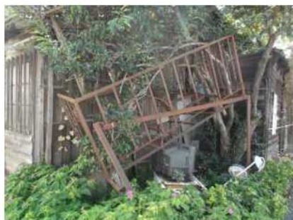
写真②：バルコニーの脱落
