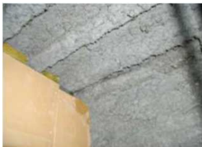
写真②：吹付け石綿
