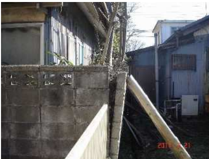
写真①：塀の傾斜
