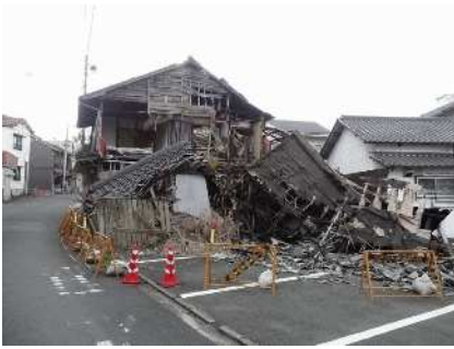
写真①：既に倒壊している
