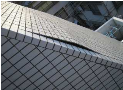
写真①：外壁の浮き
