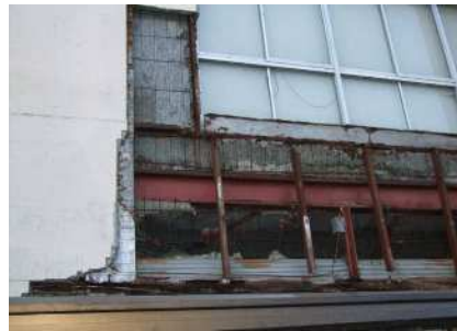
写真②：外壁の脱落
