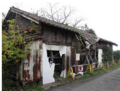
写真②：外装材の劣化・破損
