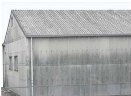
写真④：石綿使用の例 スレート波板
