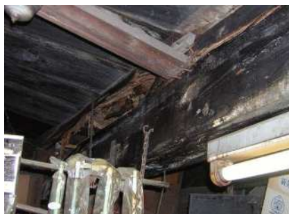
写真⑧：はりの破損・腐食の発生
