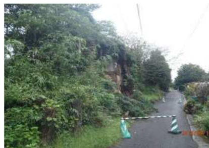
写真②：立木の倒壊による通行障害
