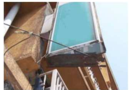
写真⑥：看板底板の腐食
