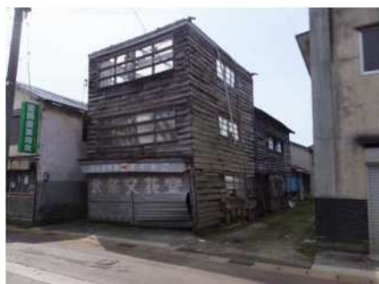
写真①：外装材の色褪せ
