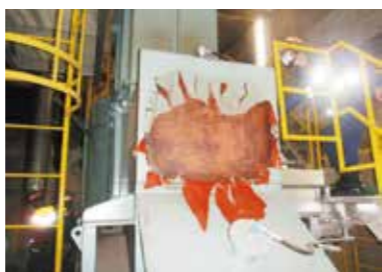
内部で火災が発生し、塗装が剥がれた設備
