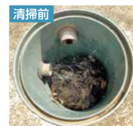
清掃前 落ち葉などが詰まり、砂利が見えない
