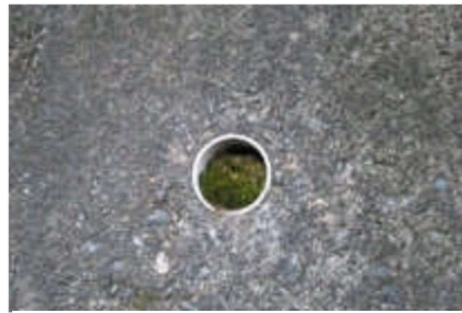
写真⑤：水抜き穴の詰まり
