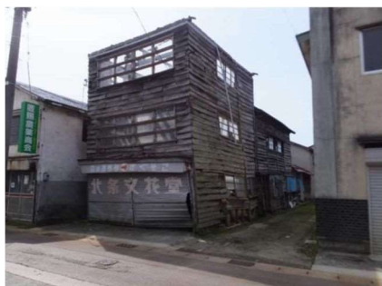
写真①：外装材の色褪せ
