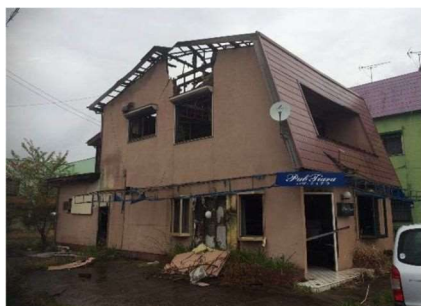
写真①：開口部等の破損
