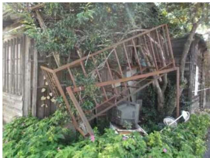
写真②：バルコニーの脱落
