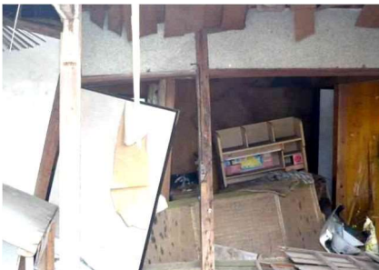
写真①：家財ごみの放置
