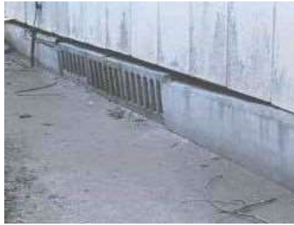
写真②：構造材(基礎)の破損
