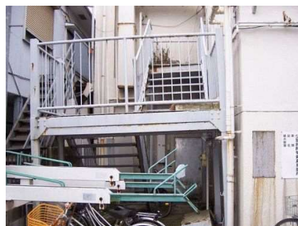
写真③：屋外階段の傾斜
