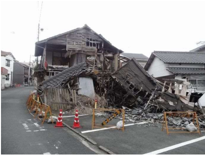
写真①：既に倒壊している
