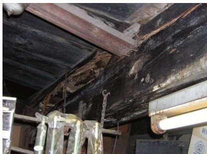
写真⑧：はりの破損・腐食の発生
