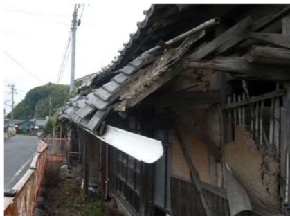
写真①：軒の破損
