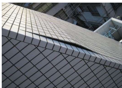
写真①：外壁の浮き
