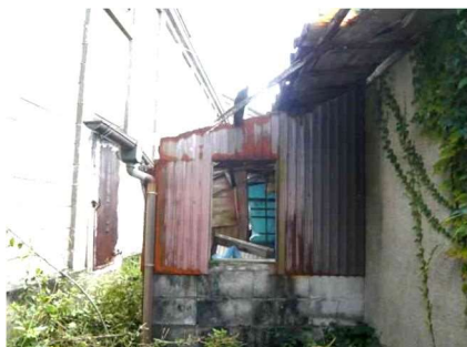
写真④：開口部等の破損
