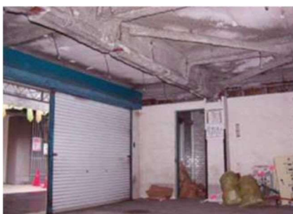
写真①：吹付け石綿の露出
