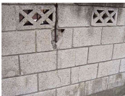
写真②：塀の大きなひび割れ
