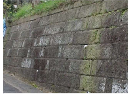
写真③：擁壁のふくらみ
