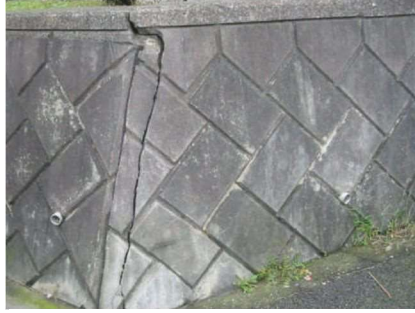
写真②：コーナー部分のひび割れ
