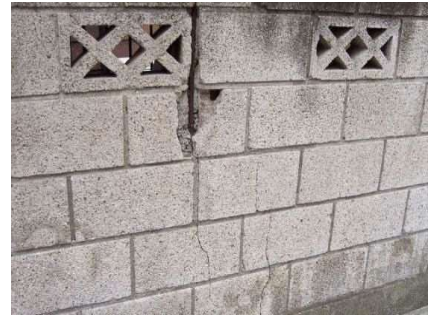
写真③：塀の大きなひび割れ
