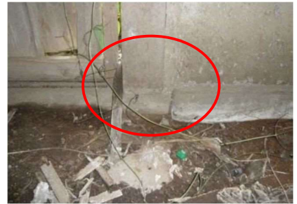
写真⑥：基礎、土台がずれている
