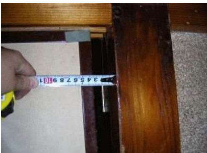
写真⑦：柱の傾斜
