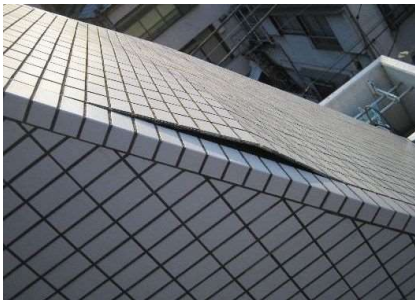
写真①：外壁の浮き
