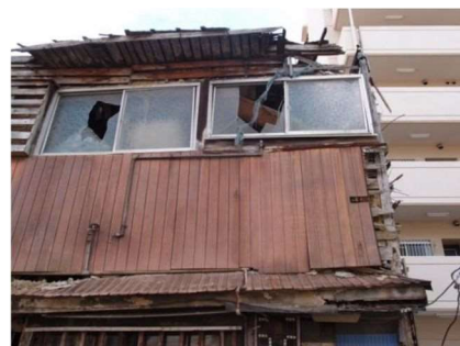
写真③：外装材の破損・窓ガラス破損
