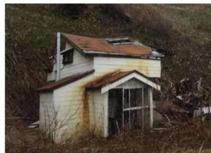
写真③：開口部の未施錠
