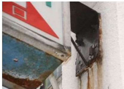
写真⑤：看板支持部分の著しい腐食
