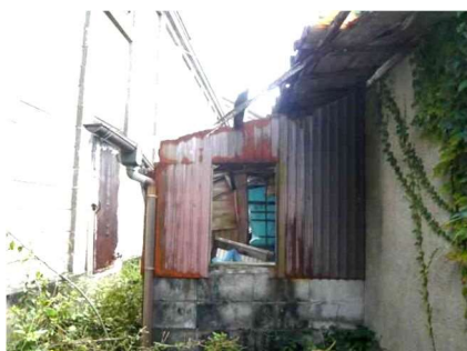
写真④：開口部等の破損
