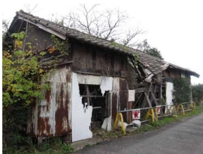
写真②：外装材の劣化・破損
