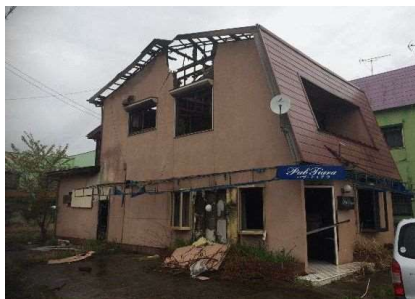
写真④：屋根の著しい破損
