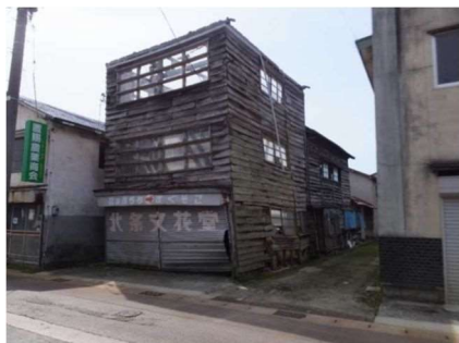
写真①：外装材の色褪せ
