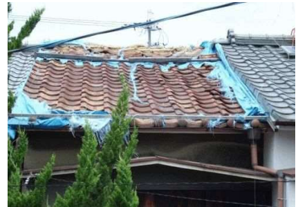
写真③：屋根ふき材の脱落
