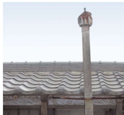
写真⑥：石綿使用部例 煙突材
