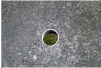
写真⑤：水抜き穴の詰まり
