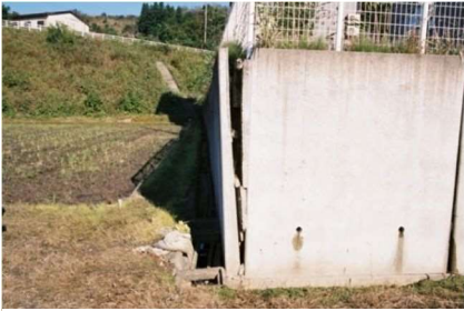
写真④：擁壁の傾き
