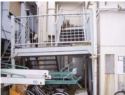
写真④：屋外階段の傾斜
