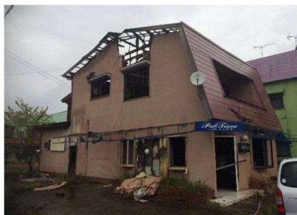
写真①：開口部等の破損
