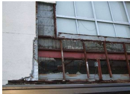
写真②：外壁の脱落
