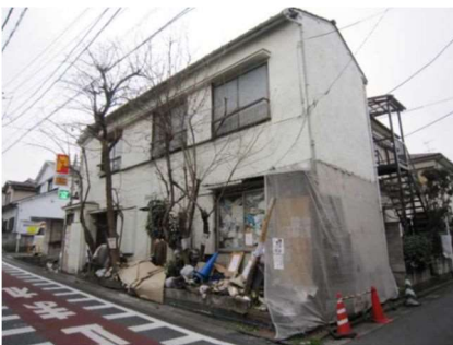
写真④：ごみの放置
