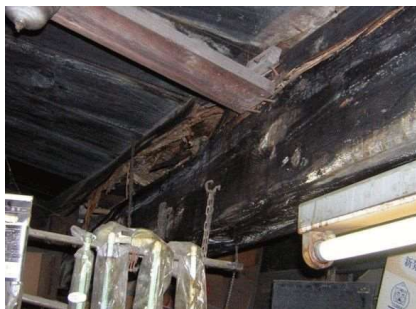
写真⑧：はりの破損・腐食の発生
