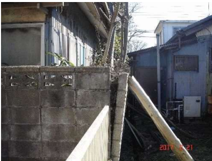
写真①：塀の傾斜
