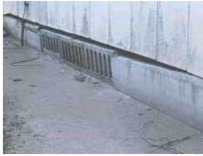
写真②：構造材(基礎)の破損
