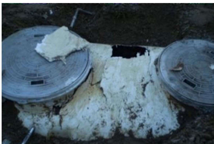
写真①：浄化槽上部の破損
