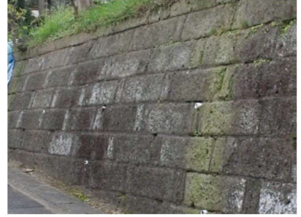
写真③：擁壁のふくらみ
