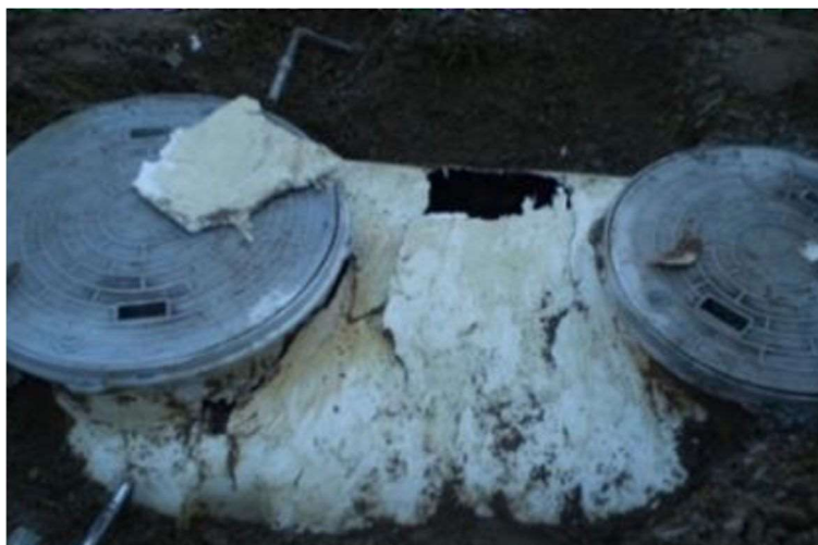
写真①：浄化槽上部の破損
