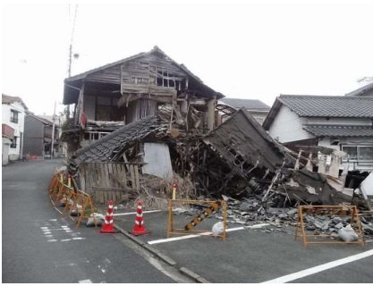
写真①：既に倒壊している
