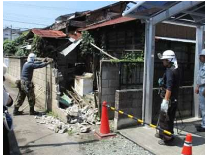
写真②：塀の破損
