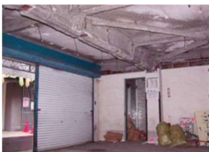
写真①：吹付け石綿の露出
