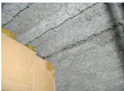
写真②：吹付け石綿
