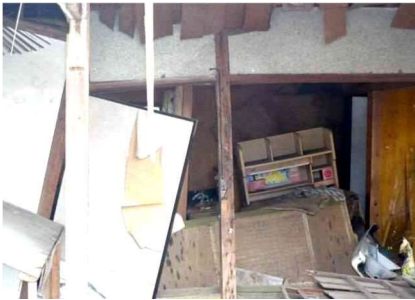
写真①：家財ごみの放置
