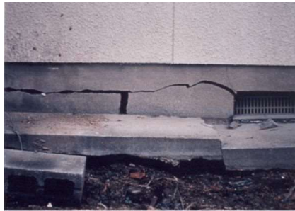
写真④：基礎の大きな欠損
