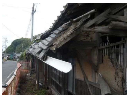
写真①：軒の破損
