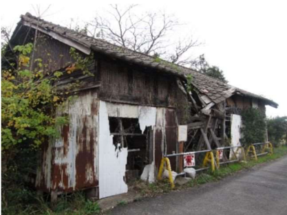
写真⑩：屋根の変形
