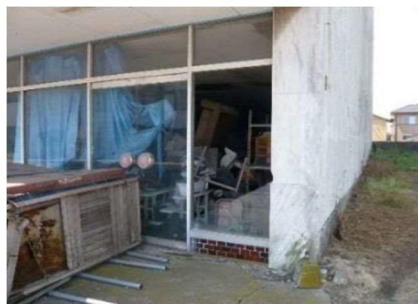
写真②：窓ガラスの破損
