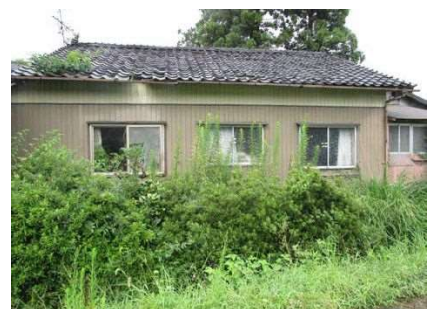
写真⑨：屋根のゆがみ
