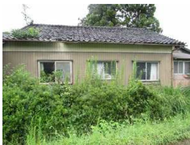
写真①：屋根のゆがみ
