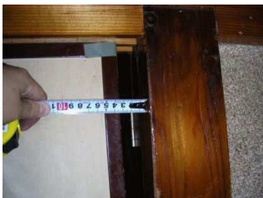
写真①: 柱の傾斜
