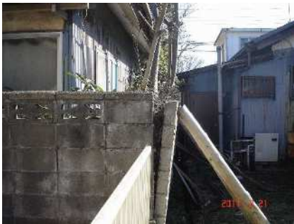
写真①：塀の傾斜
