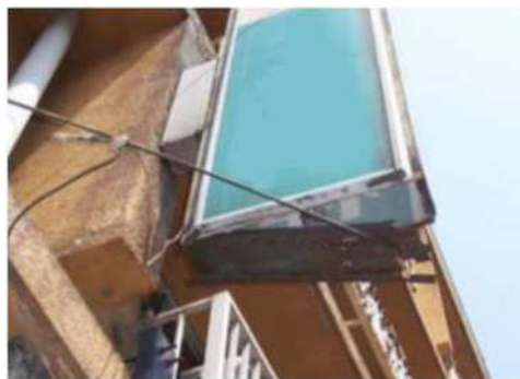
写真②：看板底板の腐食
