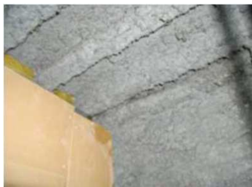
写真②：吹付け石綿等
