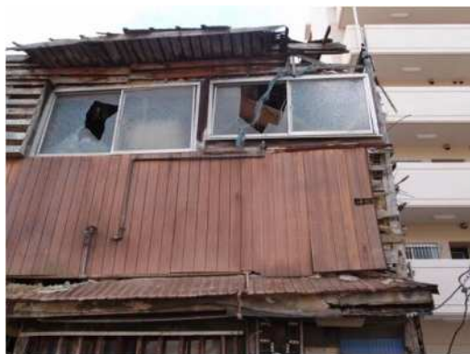
写真①：窓ガラスの割れの放置
