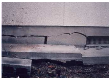
写真①：基礎の大きな欠損
