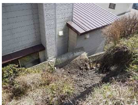
写真①：崩壊したコンクリート擁壁
