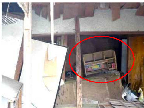
写真①：家財ごみの放置
