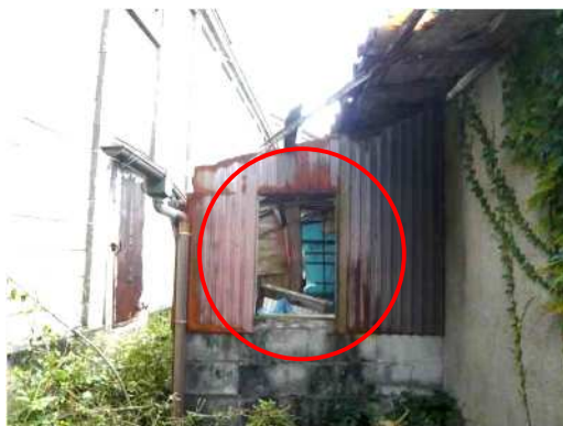
写真①：門扉がなく侵入できる
