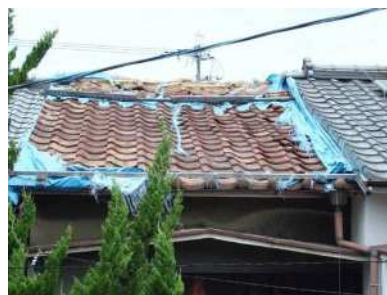
写真③：屋根ふき材の剥離脱落
