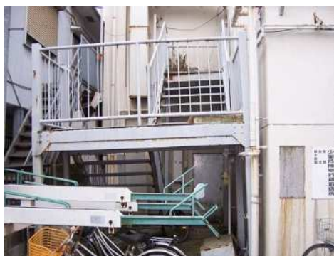
写真①：屋外階段の傾斜
