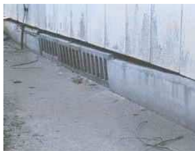
写真②：基礎の不同沈下
