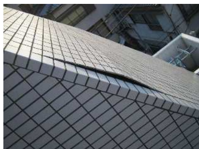
写真①：外壁の浮き
