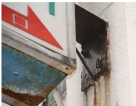
写真①：看板支持部分の著しい腐食
