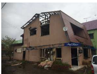
写真②：屋根の著しい破損
