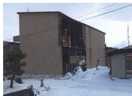
写真③：外壁の落下
