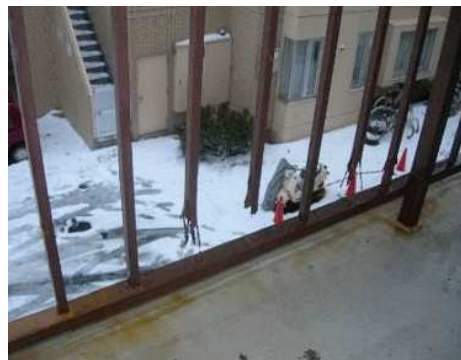
写真②：バルコニーの手すりの腐食
