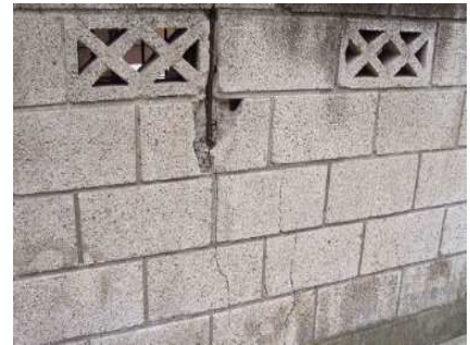
写真③：塀の大きなひび割れ
