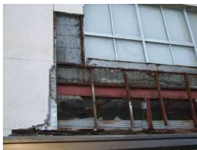
写真②：外壁の脱落
