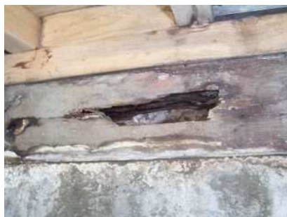
写真②：シロアリによる土台の損傷
