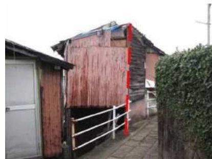
写真③：柱の傾斜
