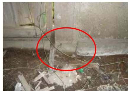
写真③：基礎、土台がずれている
