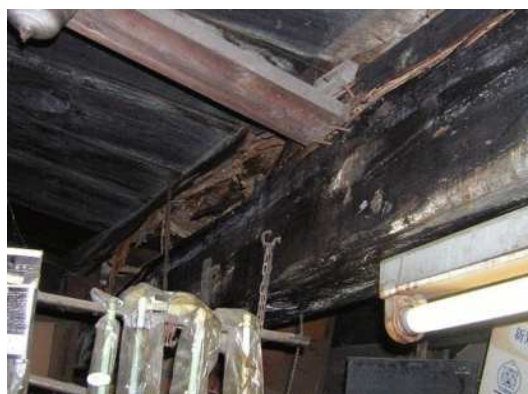
写真②: はりの破損・腐食の発生
