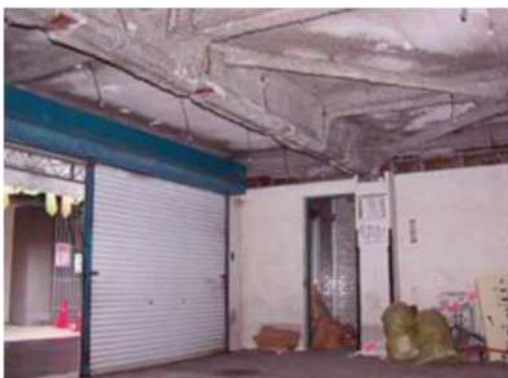
写真①：吹付け石綿等
