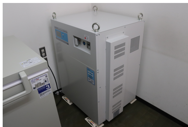
左からディープフリーザー、 無停電電源装置
