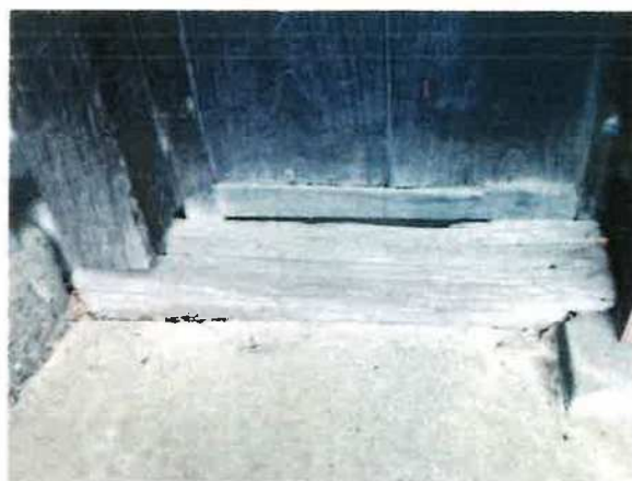
袖塀くぐり戸敷居：全体劣化
