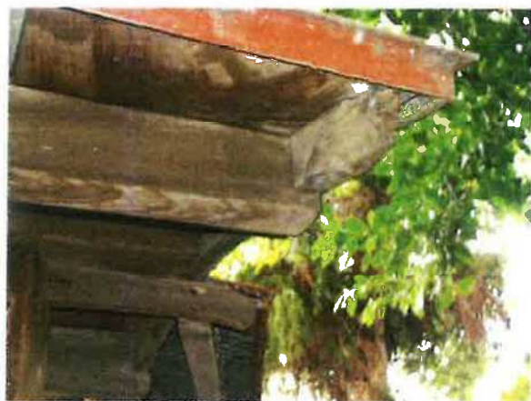
袖塀くぐり戸屋根：破風板一部腐朽
