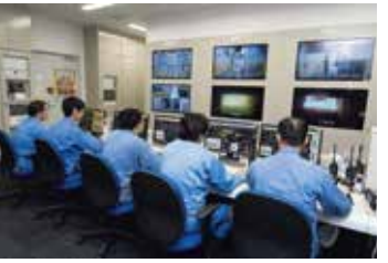
【中央制御室(5階)】 炉の状態などを24時間監視
