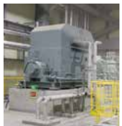
【タービン発電機】
