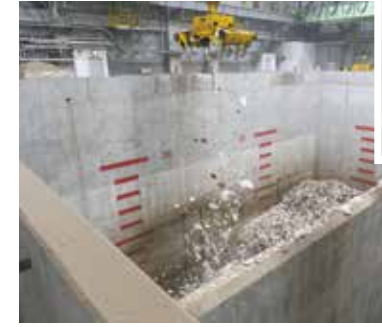
【ごみピット】ごみ収集車からのごみを直接受けるごみピット。貯留量は約9日分で従来の約4倍
