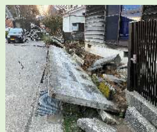
ブロック塀 （能登半島地震）
