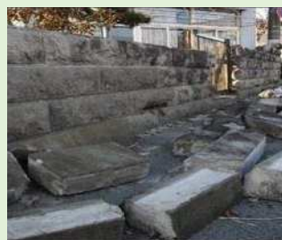
大谷石の塀 （東日本大震災）
