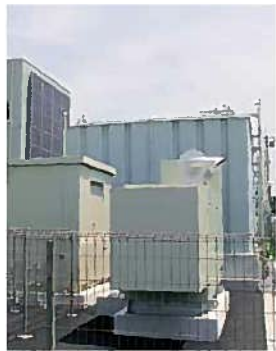
▲災害時に使用する自家発電装置
