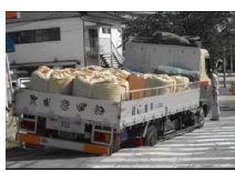
管渠破損に伴う道路陥没
