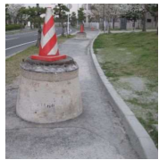
(写真) 液状化によるマンホールの浮き上がり
