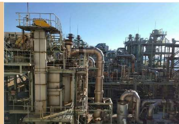
▲汚水が処理される柳島水再生センター（焼却炉）
