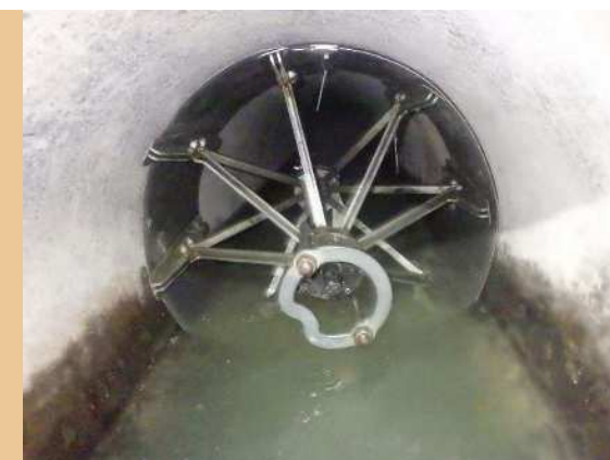
▲マンホールと管渠継手部の耐震化(マグマロック工法)
