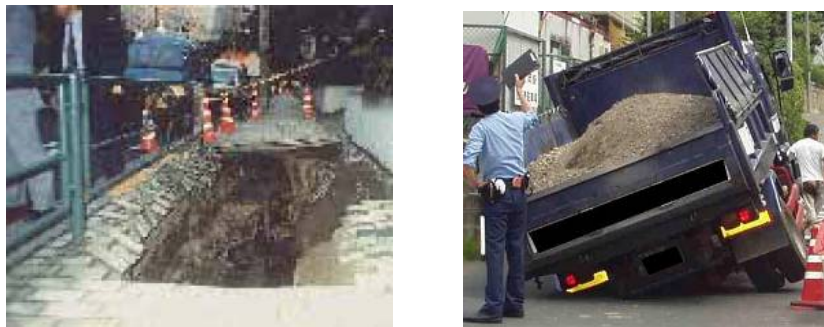
写真 管渠の劣化に起因する道路陥没事故（出典：国土交通省HP）
