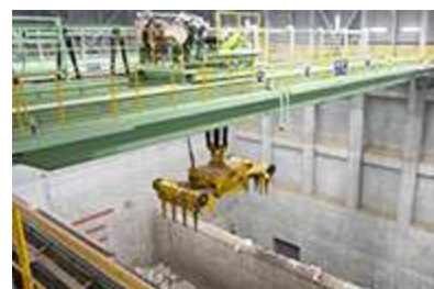
高座清掃施設組合処理施設
