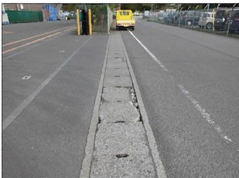
側溝の蓋の破損（蓋交換前）
