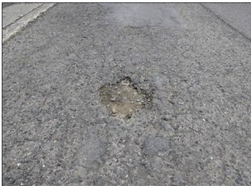
舗装補修（穴埋め前）
