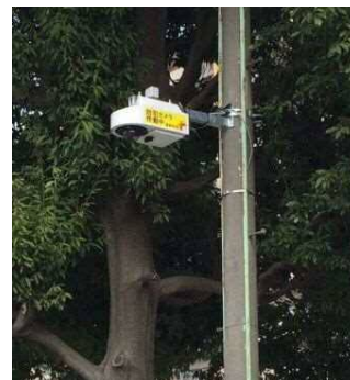
設置された防犯カメラ
